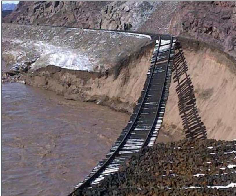
Рис. 1. Приклад втрати стійкості укосу земляного полотна
