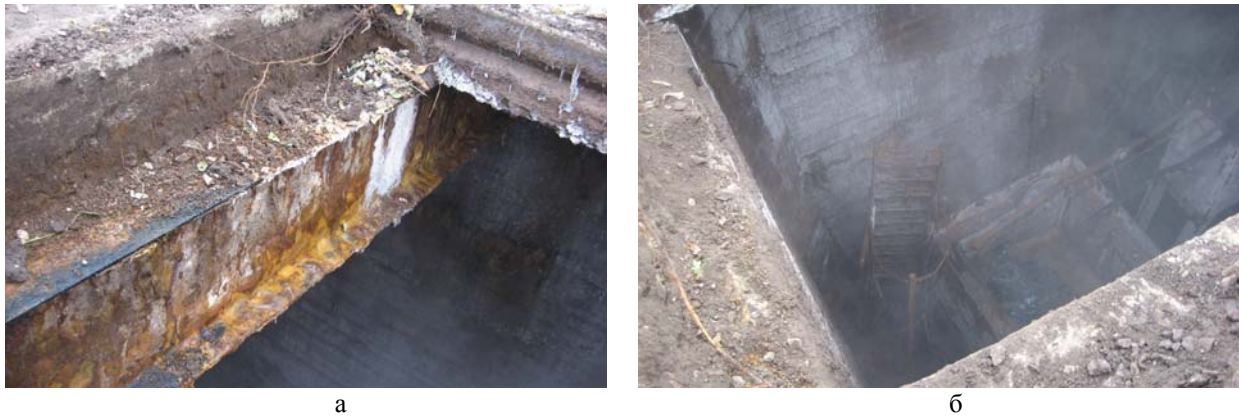
а б Рис. 5. Повреждения конструкций шахты № 1: а – коррозия несущей балки; б – обрушение лестницы
