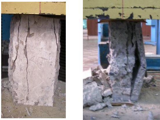
Рис. 3. Характер руйнування зразків із важкого бетону / Fig. 3. The nature of the destruction of samples of heavy concrete
