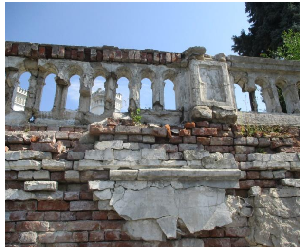
Рис. 5. Руїнування цегляної кладки підпірної стіни на глибину 250 мм / Fig. 5. The destruction of the brickwork of the retaining wall to a depth of 250 mm
