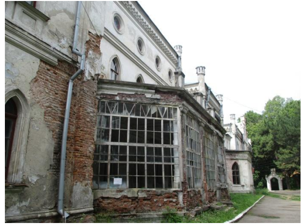
Рис. 8. Веранда палацу знаходиться в аварійному стані / Fig. 8. The veranda of the palace is in a state of emergency
