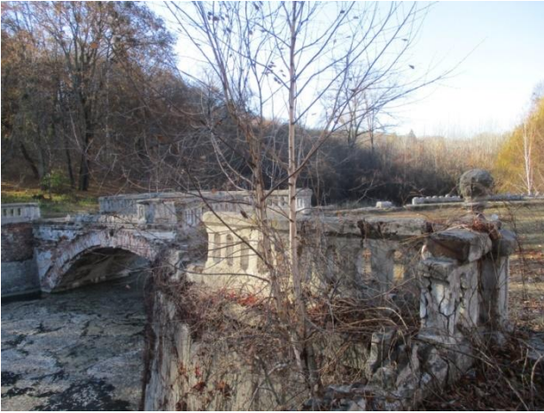
Рис. 6. Балюстрада нижньої тераси зруйнована / Fig. 6. The balustrade of the lower terrace is destroyed
