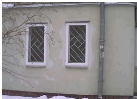
Рис. 2. Фрагмент ограждающей конструкции с двухрамным оконным блоком, при установке второго оконного блока в слое утеплителя вровень с наружной гранью утеплителя/
